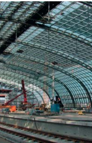
Europas innovativste Photovoltaikanlage auf dem Dach des Berliner Hauptbahnhof-Lehrter Bahnhof nahm ihren Betrieb 2002 auf.
