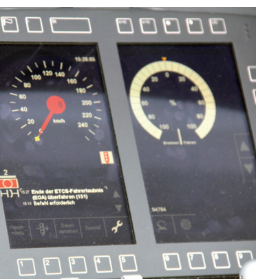
Im Fahrzeug eingebauter ETCS-Rechner
