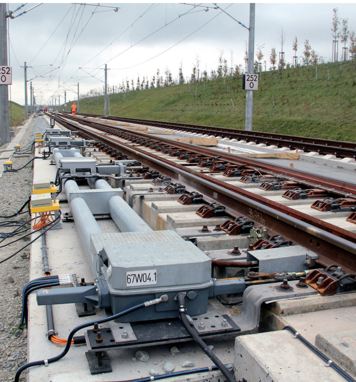
Weichenstellung über ESTW – Ein- und Ausfahrt in einen Überholbahnhof
