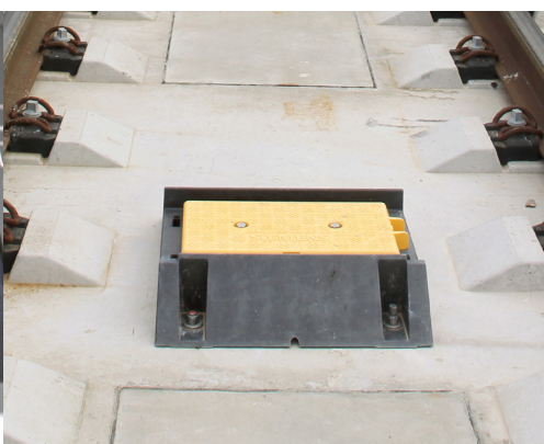
Balise, mindestens alle 1000 Meter im Gleis montiert
